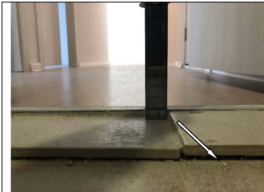
Фото №64. Зазор между напольными плитками в ванной комнате. Отсутствие затирочного раствора в шве.
