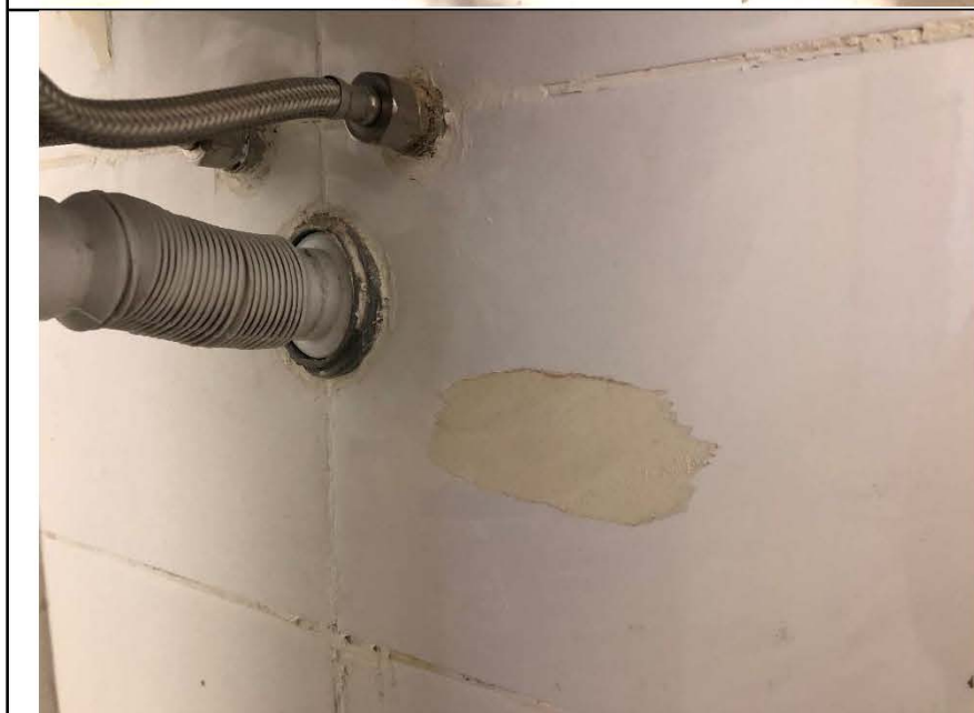
Фото №60. Дефект шва настенной плитки
