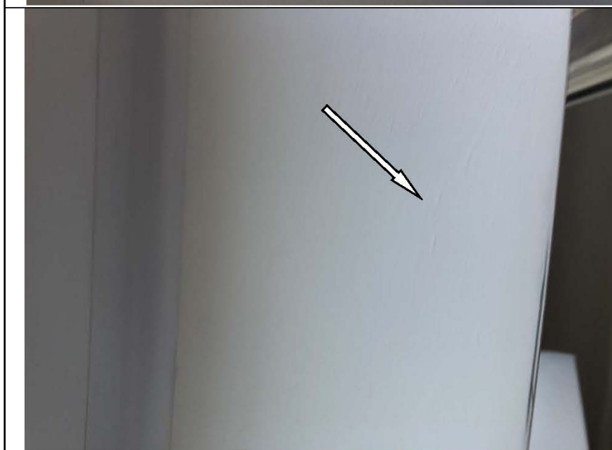
Фото №54. Дефект на откосе оконного блока в спальне.
