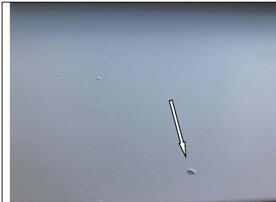
Фото №40. Загрязнение подоконника в гостиной
