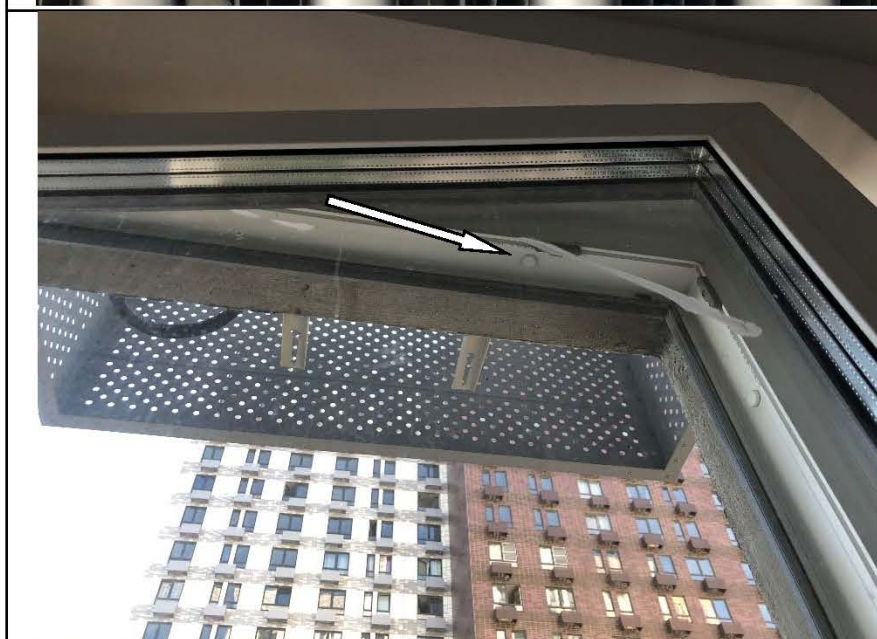
Фото №56. Загрязнение на стеклопакете оконного блока ПВХ в спальне.
