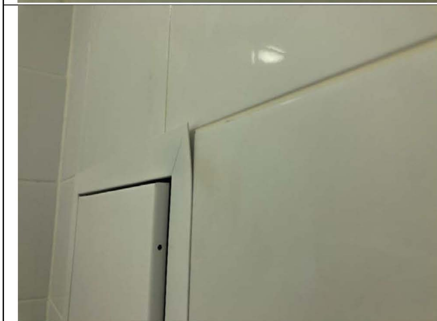
Фото №66. Дефект сантехнического люка в санузле.
