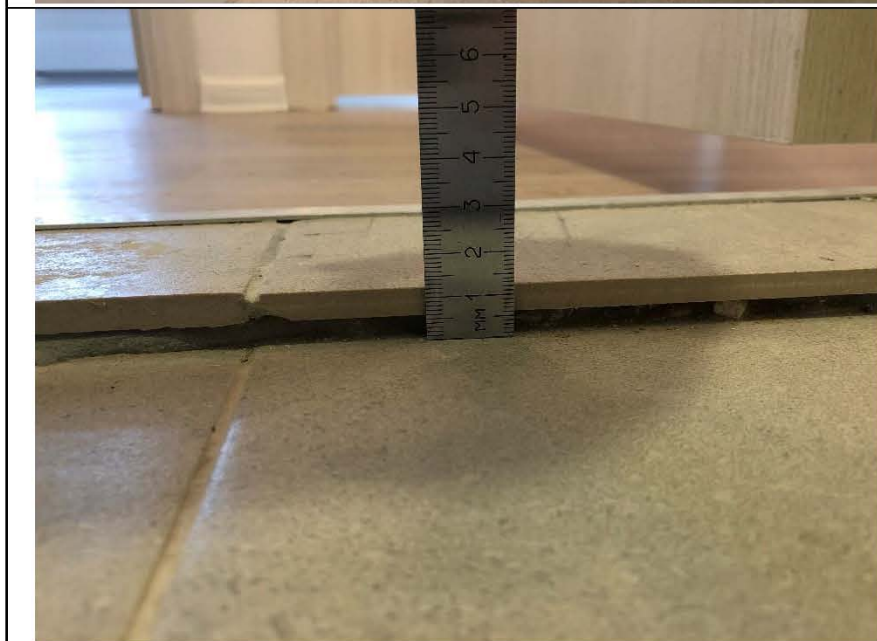
Фото №69. Отсутствует затирочный раствор в шве напольной плитки в санузле.
