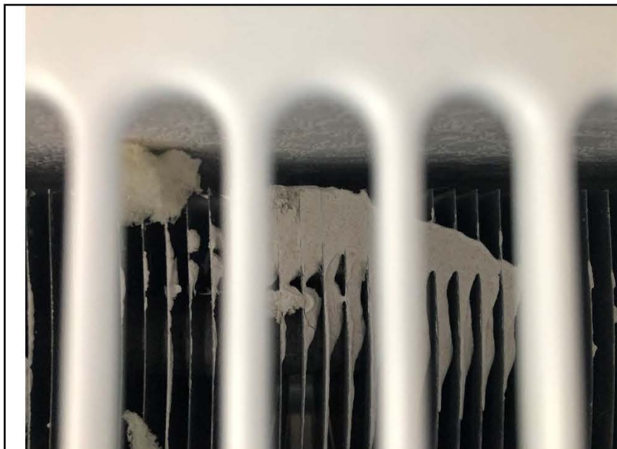
Фото №55. Загрязнение радиатор отопления в спальне.
