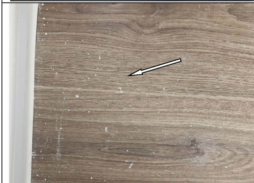
Фото №30. Загрязнение ламината краской на кухне.
