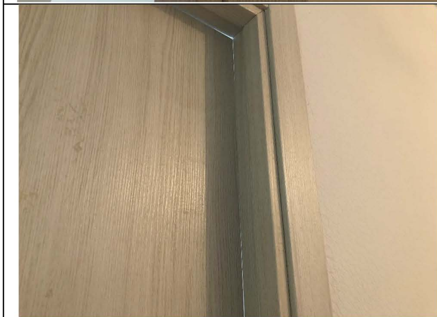
Фото №36. Дверной блок в гостиной не обеспечивает безотказное открывание и закрывание двери
