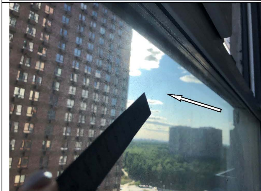
Фото №41. Царапина на стеклопакете оконного блока ПВХ в гостиной.
