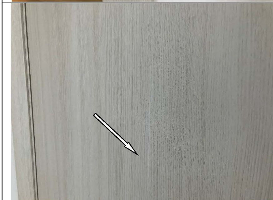
Фото №48. Дефект полотна двери в спальне (загрязнения).
