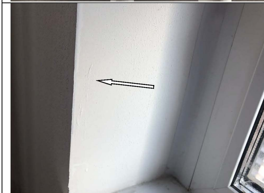
Фото №39. Дефект на откосе оконного блока в гостиной.
