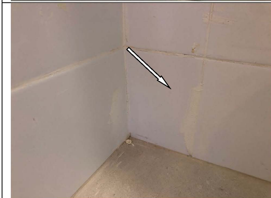
Фото №68. Загрязнение настенной плитки в санузле.
