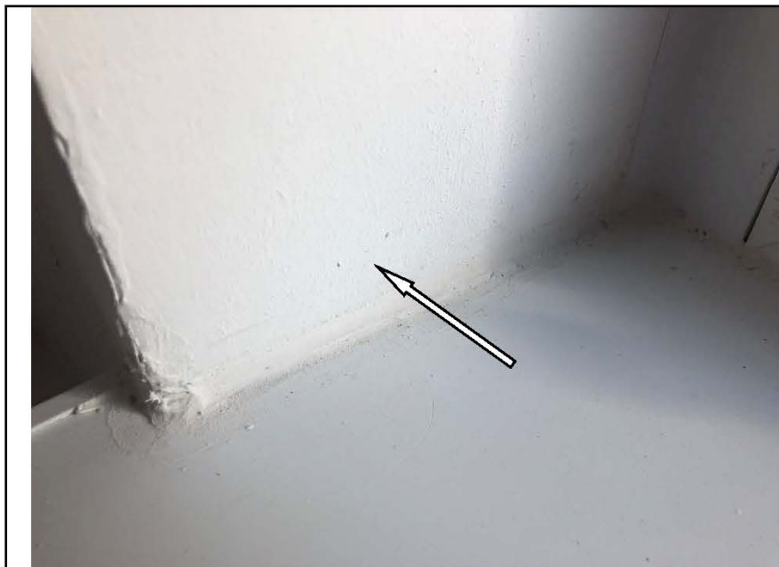
Фото №25. Дефект на откосе оконного блока в кухне.
