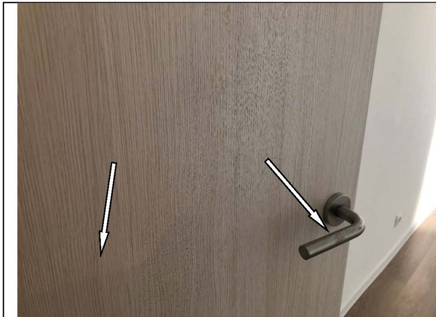
Фото №34. Дефект фурнитуры и полотна двери в гостиной (загрязнения).
