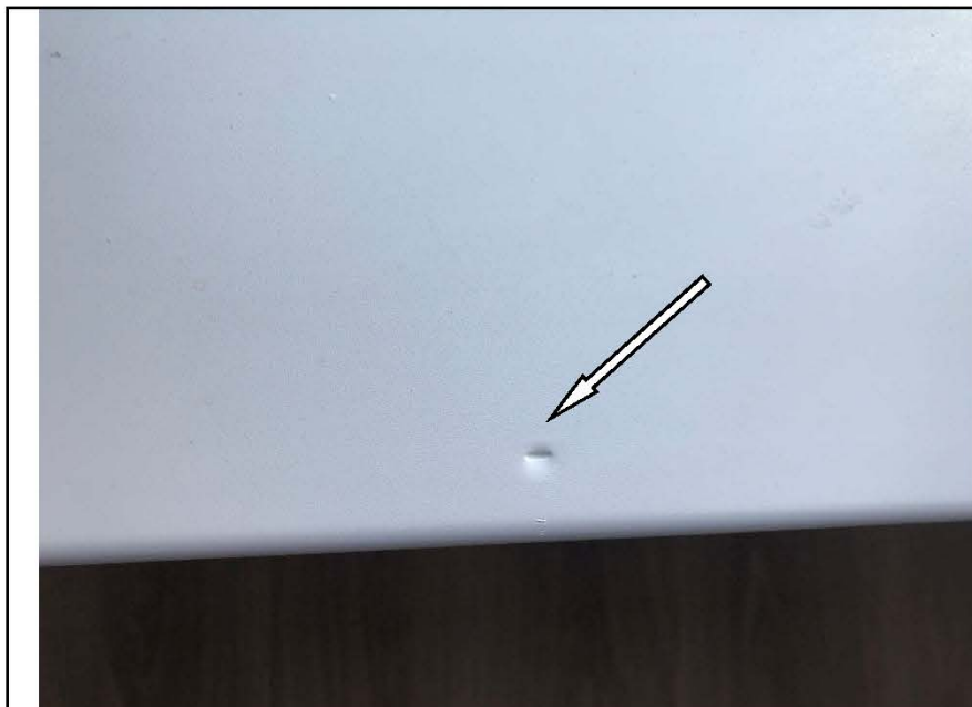
Фото №28. Дефект подоконника на кухне
