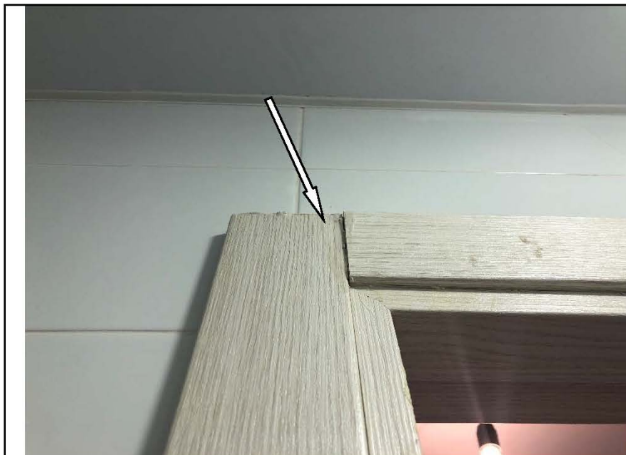
Фото №70. Дефект дверного наличника в санузле.
