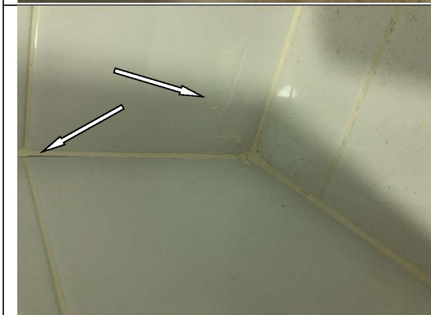
Фото №65. Загрязнение на настенной плитке в ванной комнате. Дефект шва.
