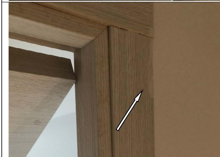
Фото №35. Дефект наличника двери в гостиной (загрязнен).
