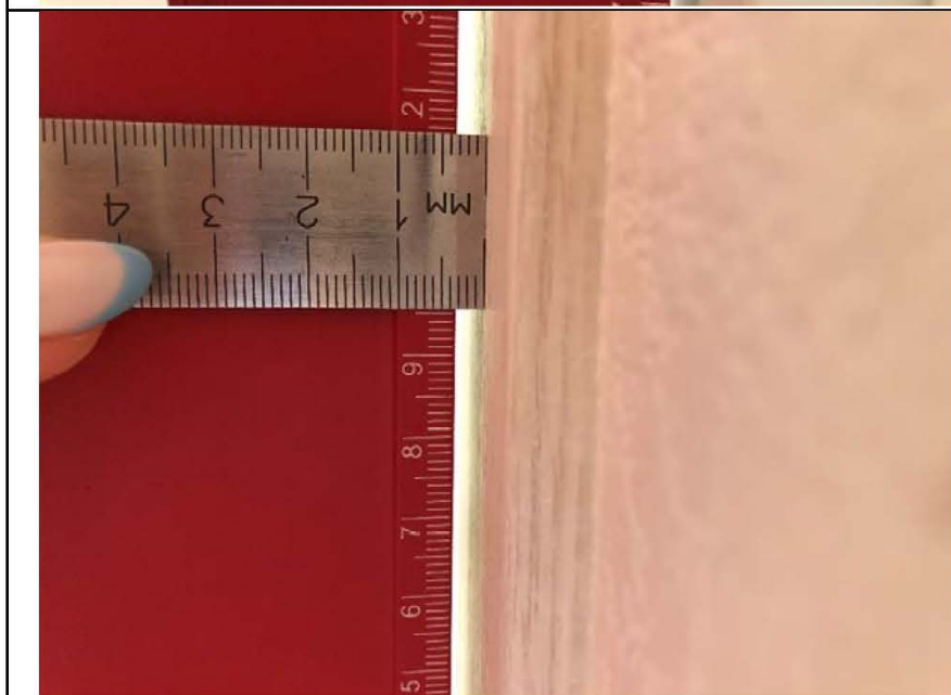
Фото №18. Дверной наличник в санузле имеет отклонение.
