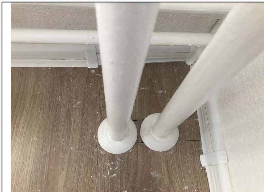
Фото №49. Загрязнение ламината краской в спальне.
