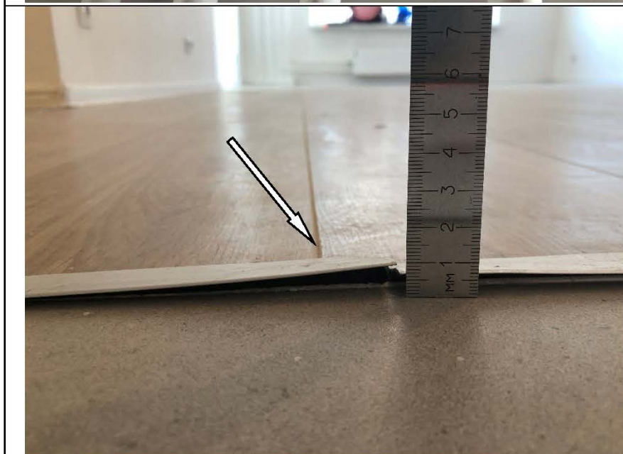
Фото №32. Деформация металлического порожка в кухне.
