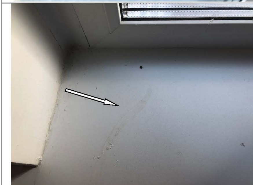
Фото №53. Загрязнение подоконника в спальне.
