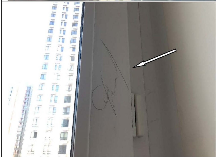
Фото №42. Дефект оконного профиля ПВХ в гостиной (загрязнение).
