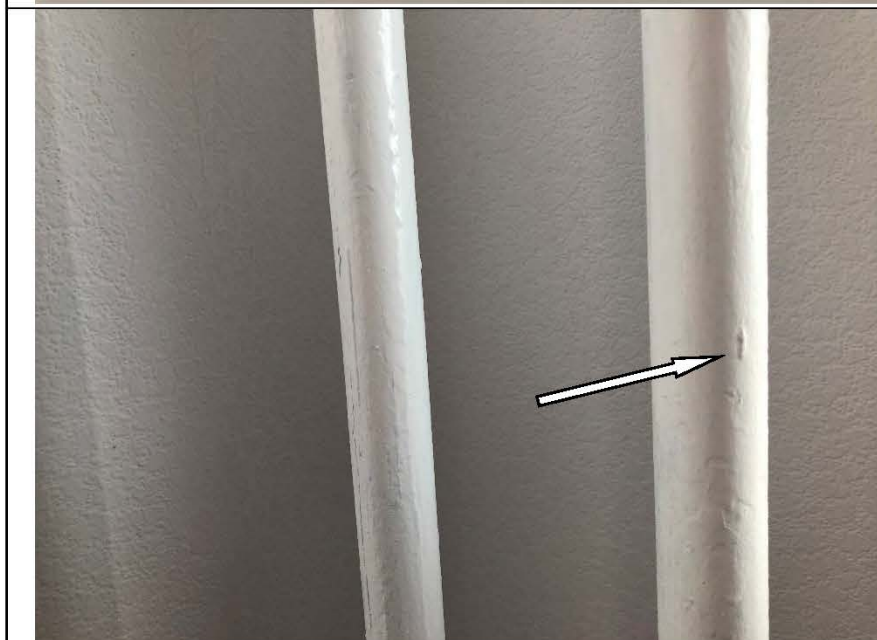
Фото №38. Дефект окрашивания краской труб отопления в гостиной.
