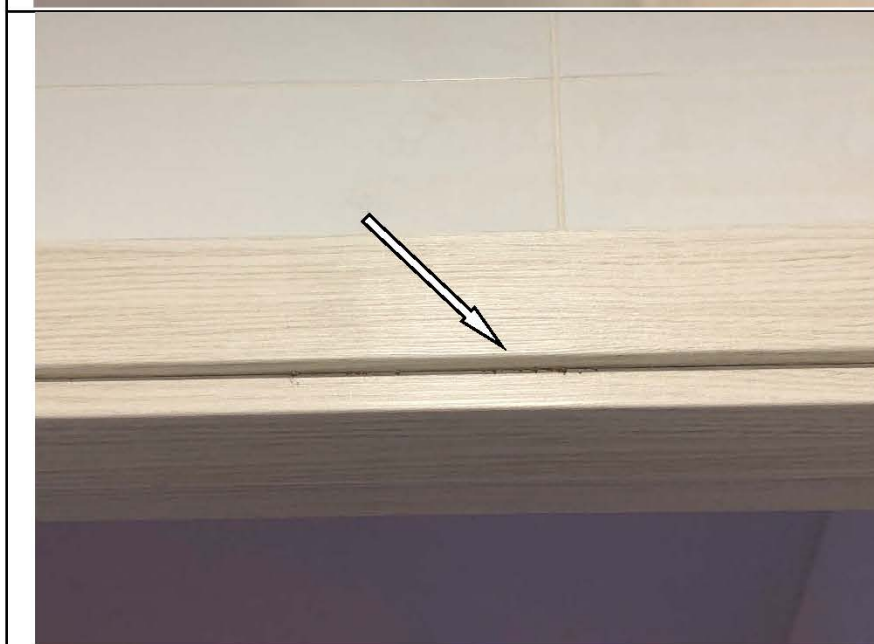
Фото №63. Дефект на дверной коробке в ванной комнате.
