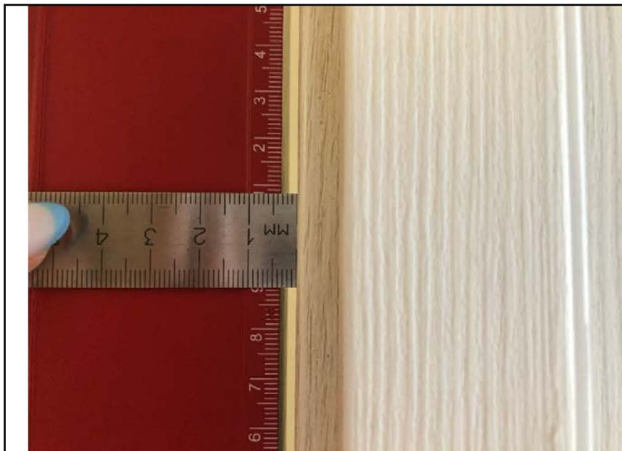
Фото №19. Дверной наличник в спальне имеет отклонение.
